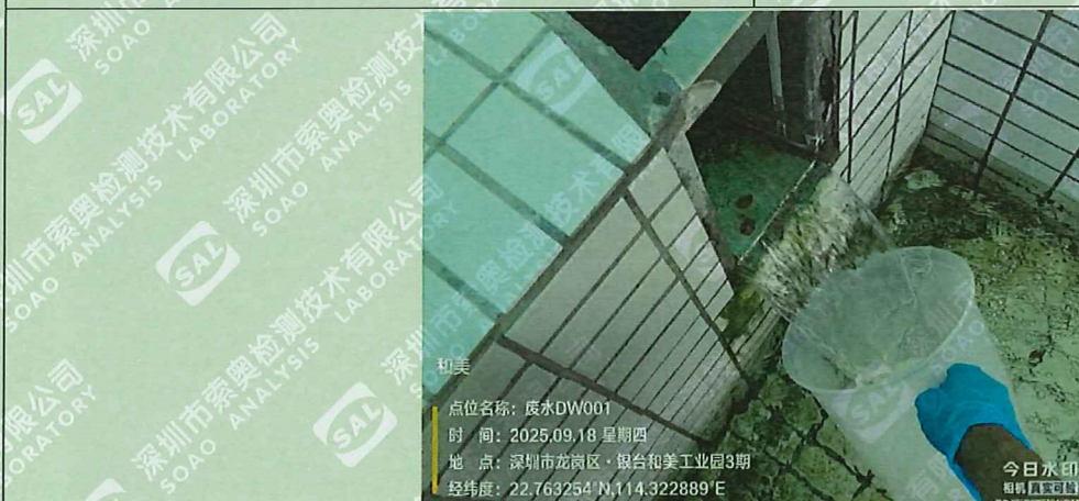
DW001 含镍废水排放口 (3#★)
