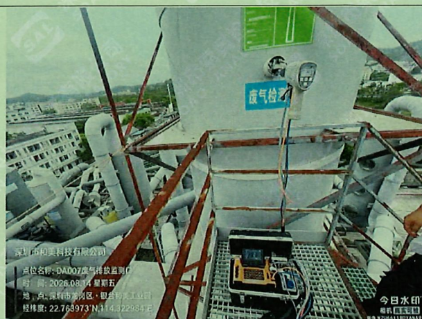
DA007 2 号铬酸雾废气排放监测口 (2#◎)
