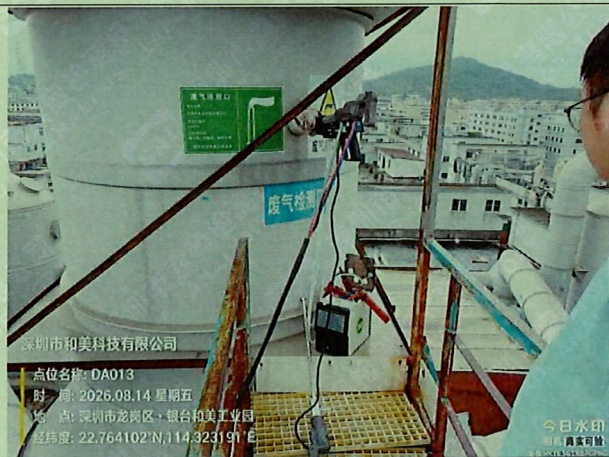
DA013 9 号酸性废气排放监测口 (4#◎)
