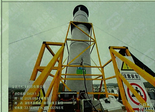
DA011 8 号酸性废气排放监测口 (3#◎)
