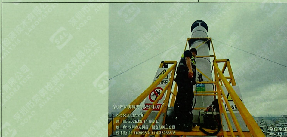
DA019 11 号酸性废气排放监测口 (6#◎)
