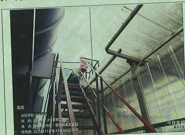
DA009 6号酸性废气排放监测口 (1#◎)
