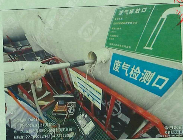
DA015 2号氰化氢废气排放监测口 (2#◎)
