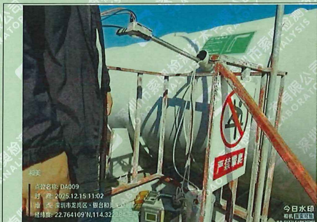
DA009 6 号酸性废气排放监测口 (1#◎)
