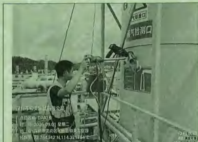
DA018 4 号氰化氢废气排放监测口 (18#◎)
