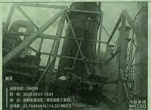
DA008 5号酸性废气排放监测口 (8#◎)
