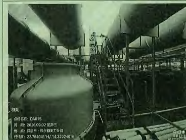
DA015 2 号氰化氢废气排放监测口 (15"◎)
