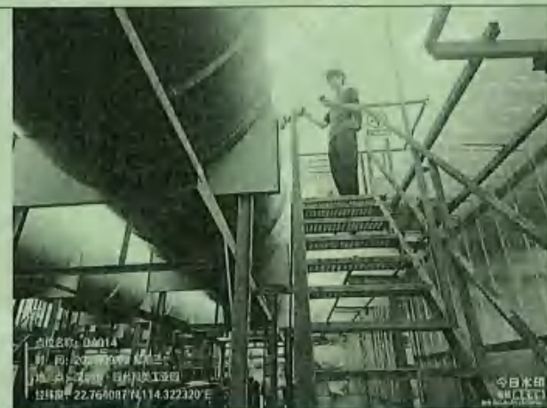
DA014 4 号铬酸雾废气排放监测口 (14"◎)
