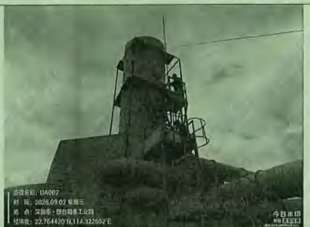
DA002 2号酸性废气排放监测口 (2#◎)
