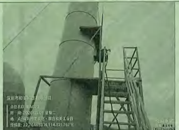
DA020 10 号酸性废气排放监测口 (20#◎)
